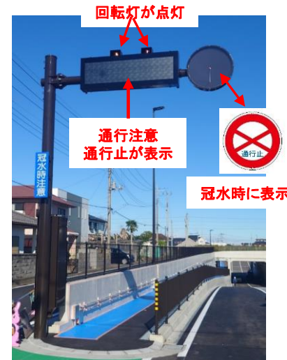
冠水表示板と可変規制標識
