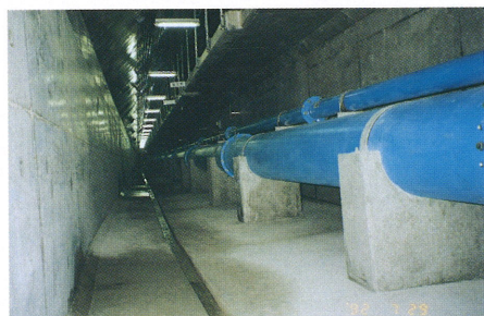
同時に整備された共同溝
