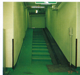
搬送コンベアー
