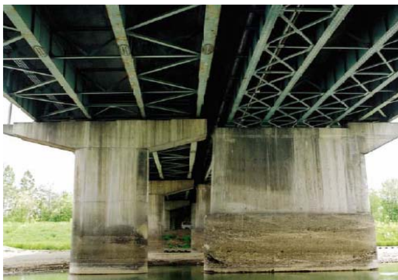
河床洗堀により橋脚基礎の根入れ不足
